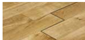
Se forman hendiduras irregulares debido al encolado lateral.
